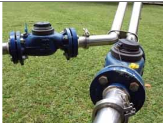
Foto 16 - Tubulações adutoras com presenças de hidrômetros para inspeção
