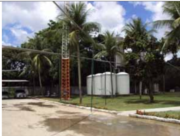
Foto 29 - Área interna de filtração livrando a água de qualquer impureza
