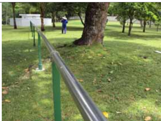
Foto 31 – Tubulação adutora de condução da água vinda da fonte
